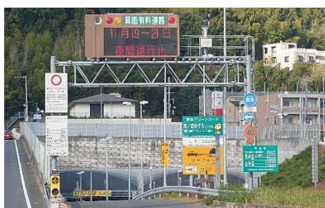
道路情報板設備（更新）
